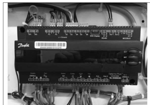
Afbbeelding 4: Normale bekabeling
